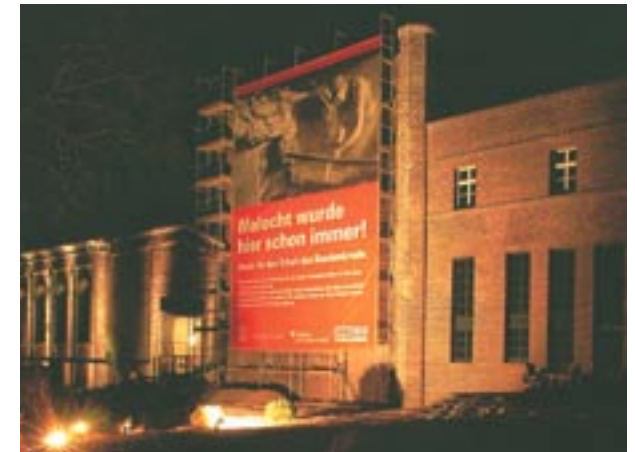
Malakowtürme, Gelsenkirchen: Die letzten im Ruhrgebiet noch erhaltenen Doppelmalakowtürme werden zu Loftwohnungen des höheren Preissegments umgebaut.
