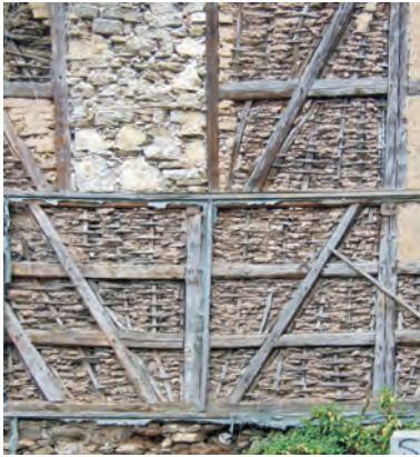
Freigelegte Konstruktion mit Gefachen mit Holzgeflecht und Lehmbewurf sowie Gefachen mit Steinen 2
